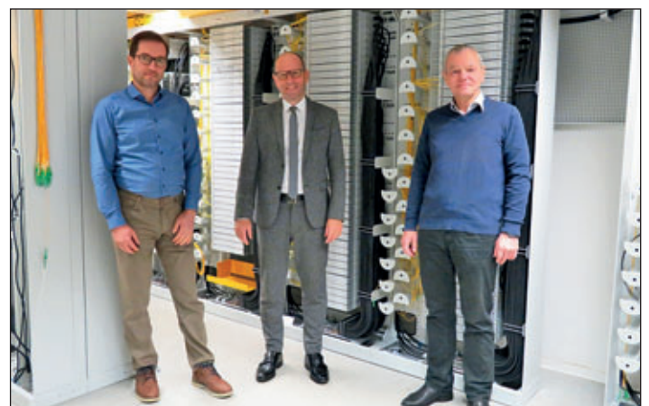
Im Gebäude der Stadtwerke Meerane GmbH in der Oberen Bahnstraße befindet sich einer von drei Hauptverteilern für das Meeraner Glasfasernetz. Stadtwerke-Prokurist Patrick Kühni, Bürgermeister Professor Dr. Ungerer und Uwe Nötzold, Geschäftsführer der Stadtwerke (v.l.n.r.). Fotos: Stadtwerke Meerane GmbH
